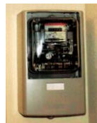
電力メーター
