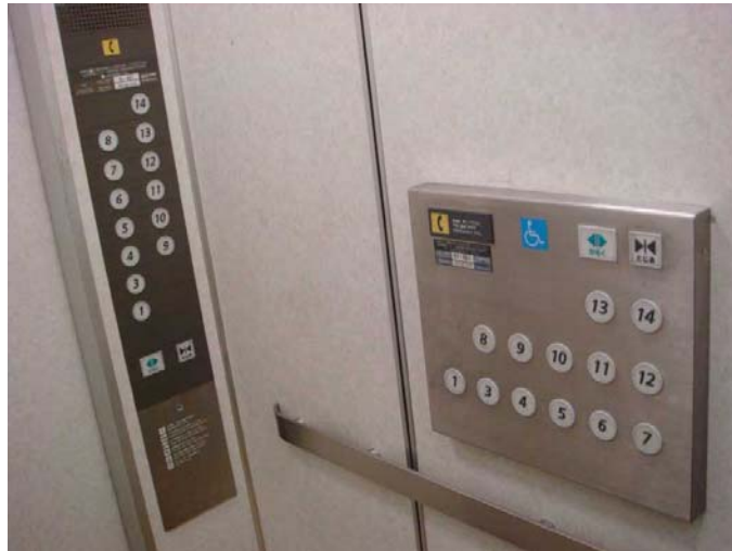
＊ 「ひらく」と「とじる」の文字も表示されたエレベーターの操作パネル
