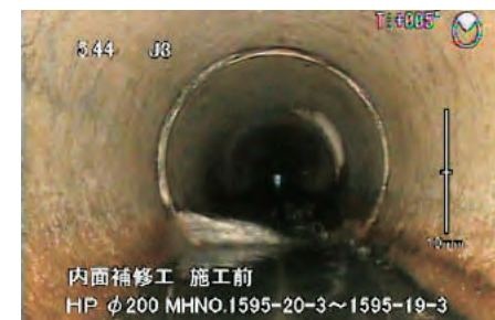
修理前の下水道管
