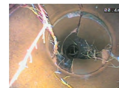
老朽化した取付管(陶管)
