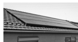
太陽光発電設備の例
