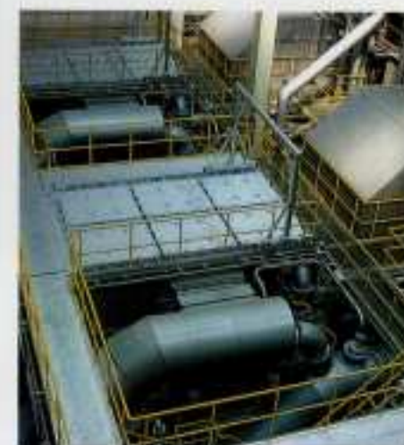
バグフィルタ：排ガス中の微細なばいじんを取り除いてきれいなガスにします。
