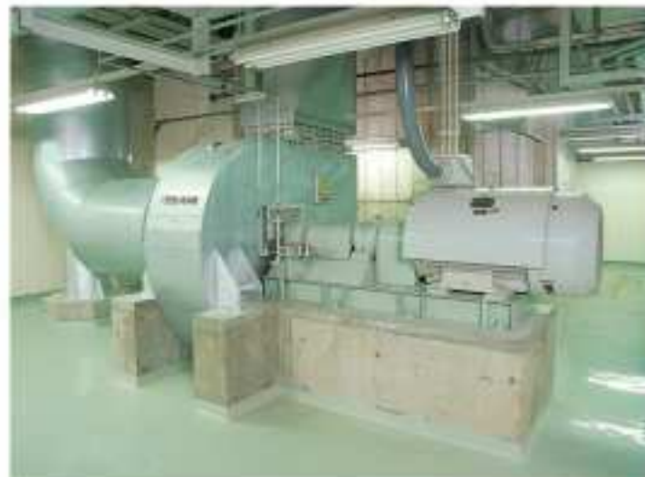
誘引通風機：バグフィルタによってきれいになった排ガスを煙突に送ります。
