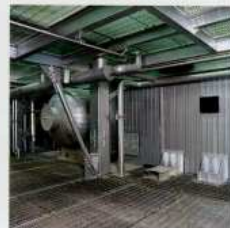
ボイラー：排ガスの熱エネルギーを回収して蒸気をつくり、施設内のタービン発電機、給湯設備などに活用します。
