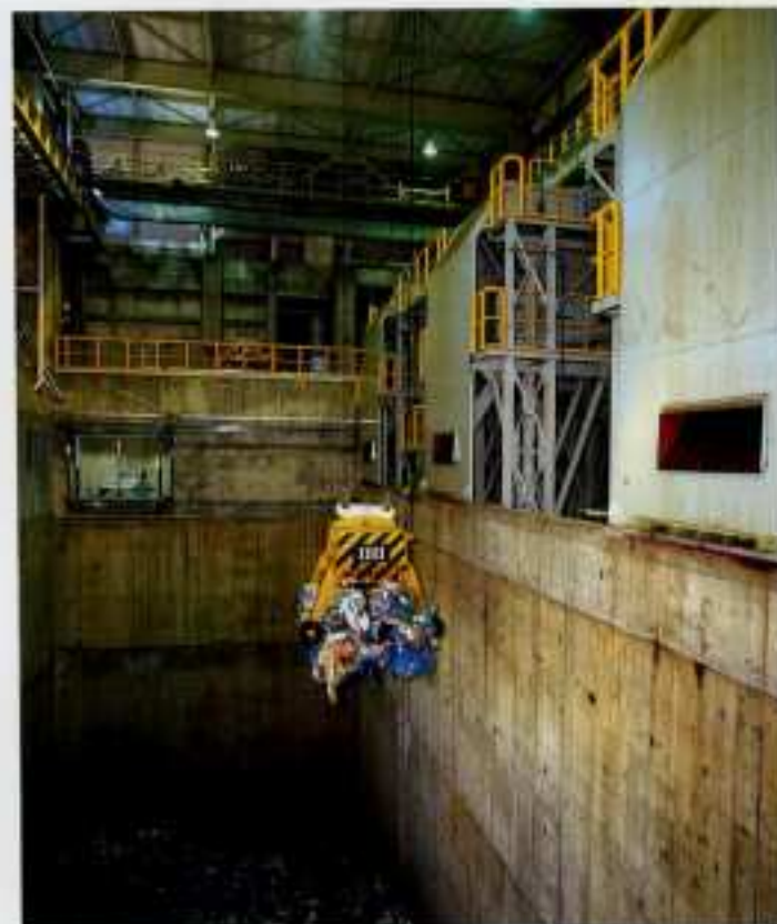
ごみピット・ごみクレーン：収集車から投入されたごみを貯留し、クレーンによってよくかき混ぜてからホッパに投入します。
