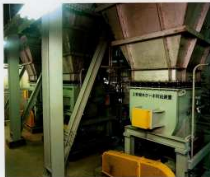
脱水ケーキ切出装置：脱水ケーキを貯槽からポンプへ切り出します。
