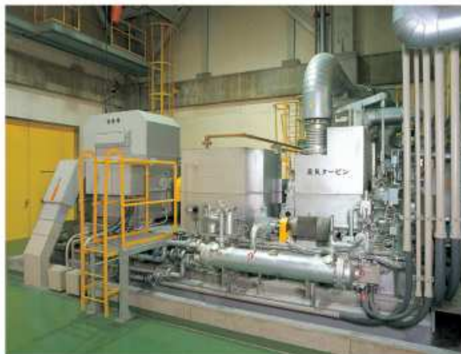
蒸気タービン発電機：ボイラで発生した蒸気で発電を行い、施設内で必要な電力の一部をまかいます。
