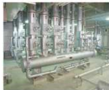
高圧蒸気だめ：ボイラで発生した蒸気を各所へ分配します。
