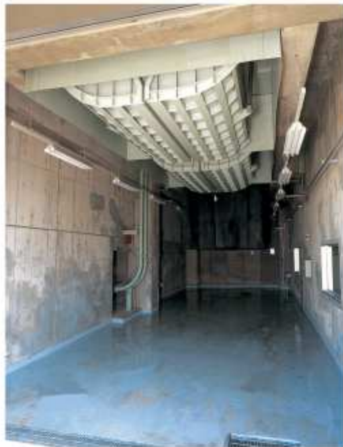
固化灰パンカ：ばいじんをセメントによって固化し一時貯留し埋め立て処分します。
