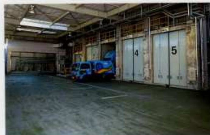
プラットフォーム：ごみを収集車からごみピットに投入します。自動開閉扉は臭気を外部に漏らさないようにしています。
