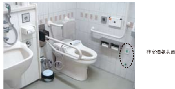
トイレの非常通報装置の例
