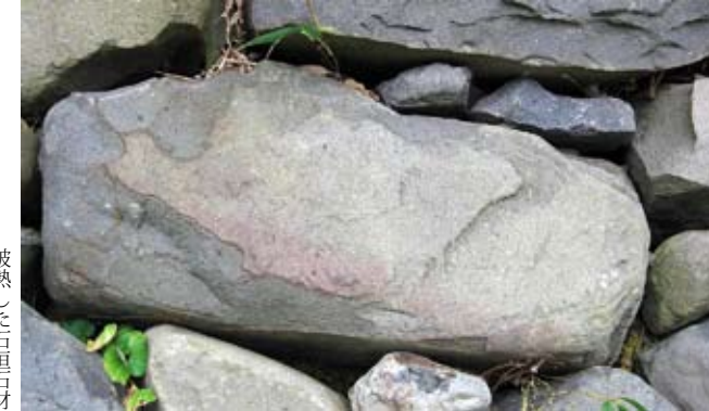
被熱した石垣石材
