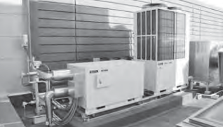
公共施設に導入された「ヒートポンプ」
