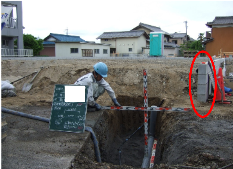
①全景図(構造物などの位置から取付管の位置がわかる写真)
