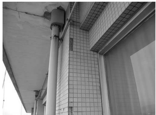
剥離したタイル
