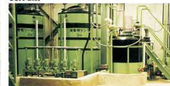
●薬品注入設備
