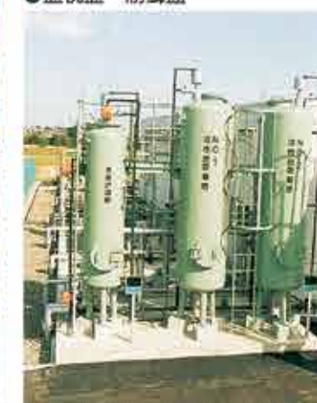
●砂ろ過設備 活性炭吸着設備
