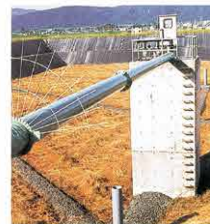
●浸出水集水ビット ガス抜き
