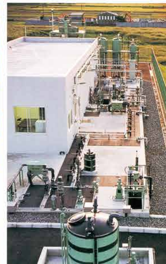
●生物処理設備 凝集沈殿設備
