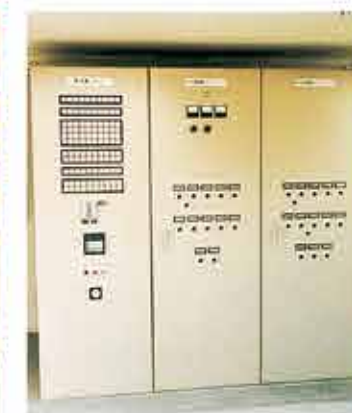
●監視盤 制御盤
