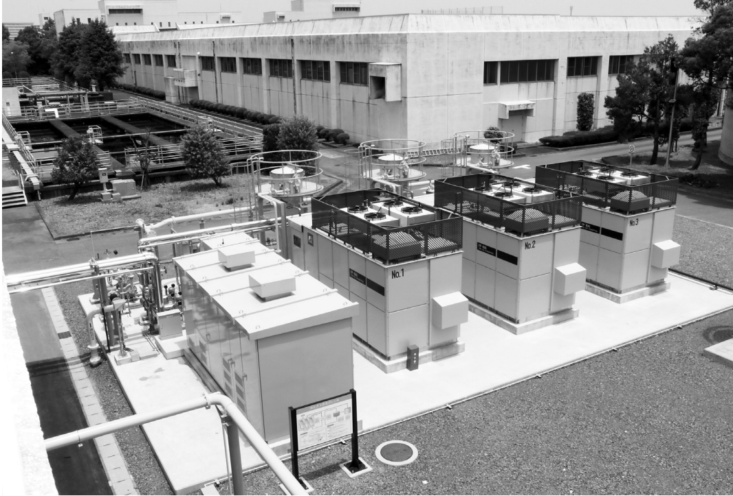
大垣市浄化センター消化ガス発電施設
