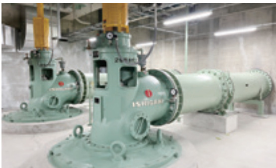
雨水を河川へ排出する雨水ポンプ(笠木排水機場)
