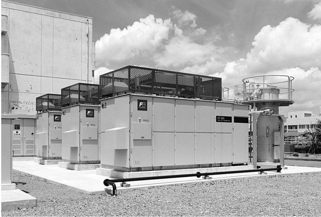
浄化センター 消化ガス発電設備
