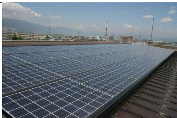
太陽光パネル（中川ふれあいセンター）
