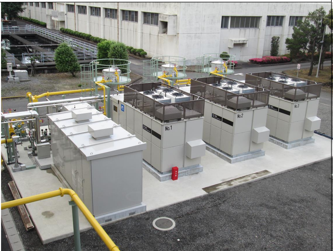
消化ガス発電施設（大垣市浄化センター）
