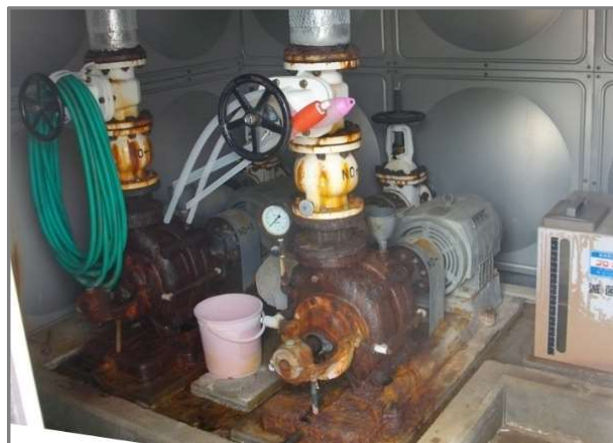
【設備の老朽化】
