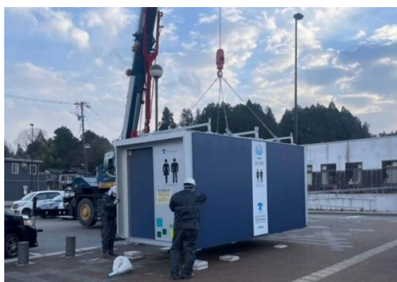
令和6年能登半島地震の被災地に派遣されたトイレコンテナ（平常時は道の駅うきはに設置）
