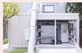
バイオマスボイラーユニット（兵庫県たつの市）
