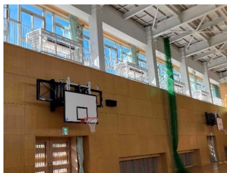
江東小学校屋内運動場に整備された空調機
