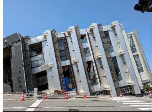
能登半島地震の被害②（倒壊した「五島屋」ビル）
