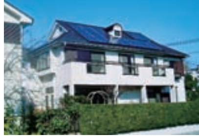
住宅用太陽光発電設備
