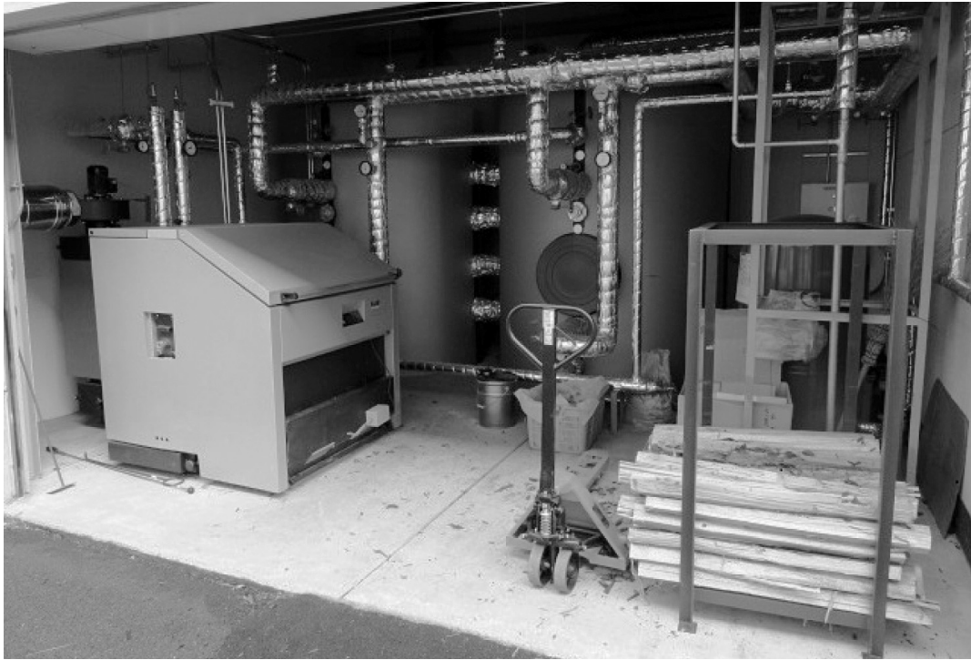
上石津地域事務所の薪ボイラー
