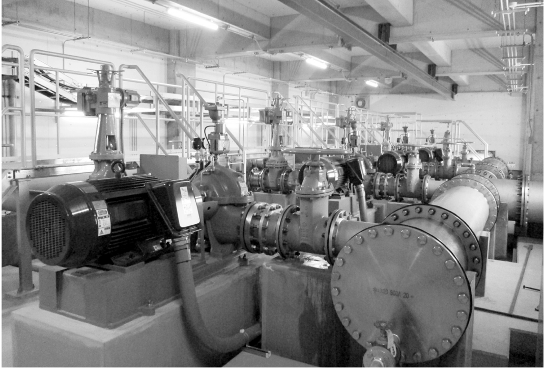
北部水源地 配水ポンプ
